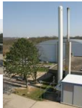
Biomasseheizwerk Wiesloch (6.000 kW) mit Notfallölkessel
